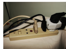
Gambar 1.29 Sambungan Kabel Listrik pada Stopkontak Perlu Diperiksa Sebelum Digunakan dalam Praktikum di Laboratorium Foto: Dokumentasi Penerbit
